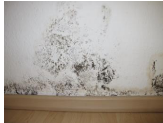
schimmel op de muur
