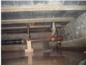
water in de kruipruimte
