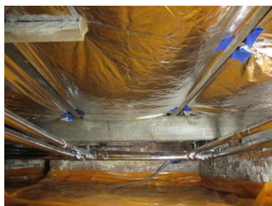
aluminium zakken onder vloer
